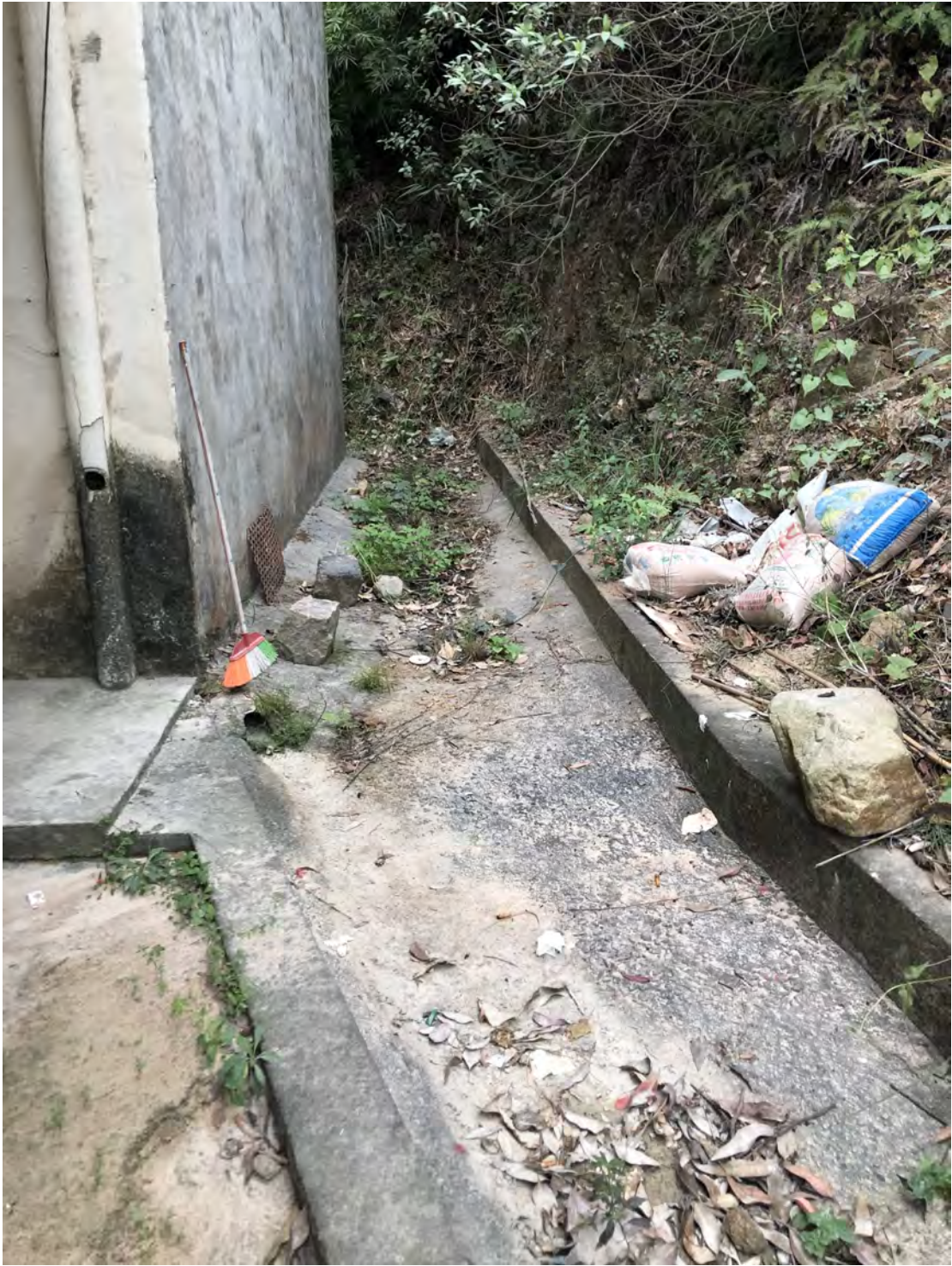
图 10：综合服务区截水沟
