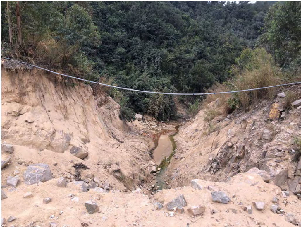
采场外围排水沟
